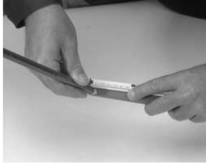
Fig. 2 Limpiar las superficies de fusión con un producto de limpieza. Marcar en el tubo la profundidad de inserción de la matriz.
