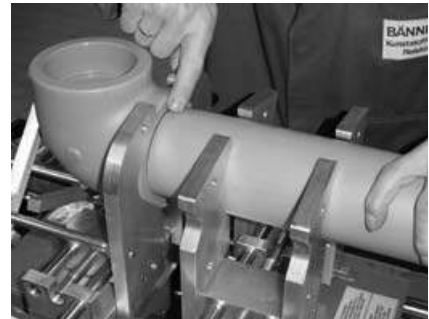
Fig. 8 Ficar el tubo orientándolo en sentido axial al accesorio y posicionarlo de manera que su lado frontal tenga contacto con el accesorio
